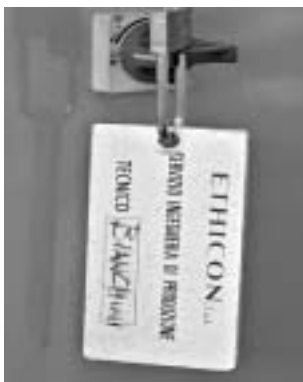
Figura 3: Lockout di un interruttore
