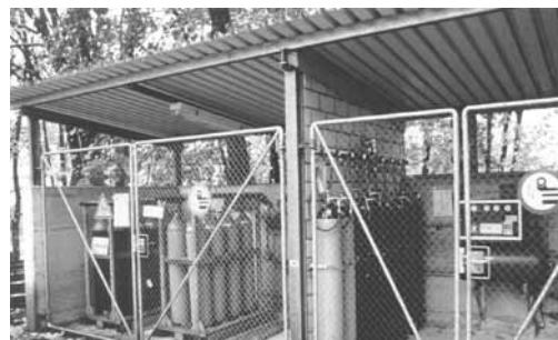
Figura 7: misure di protezione contro esplosioni su una rampa di raccordo all'aperto per bombole a gas o batterie di bombole a gas infiammabili (buona ventilazione naturale, zona-ex 1).
