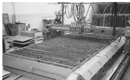
Figura 3: impianto di taglio al cannello con aspirazione a livello del piano di lavoro (sistema di aspirazione a camere multiple) e impianto di depolverizzazione.
