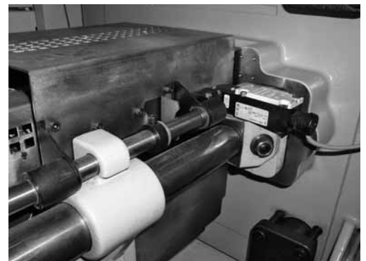
Foto 4: quando si sposta il riparo, il controllo elettrico deve arrestare l'avanzamento dell'unità di iniezione.
