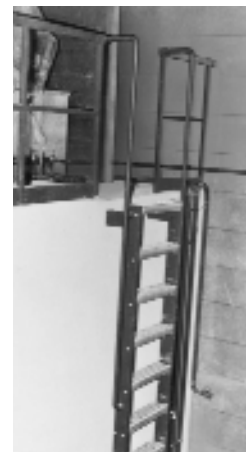
Scala di un ballatoio usato saltuariamente. I gradini della scala sono costruiti con grigliati zincati a caldo. I tubolari applicati al piano d'arrivo superiore permettono una sicura presa per le mani.
