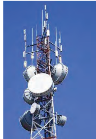
Fig. 22. Gruppo di antenne per telecomunicazioni.
