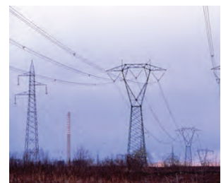
Fig. 23. Linee elettriche ad alta tensione.
