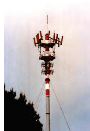
Fig. 26. Una stazione radio base (SRB).
