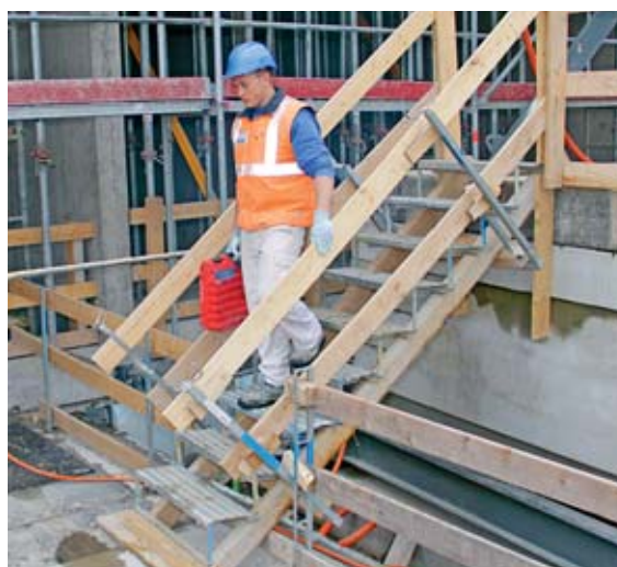
Scala libera. L'operatore può tenersi comodamente al corrimano.
