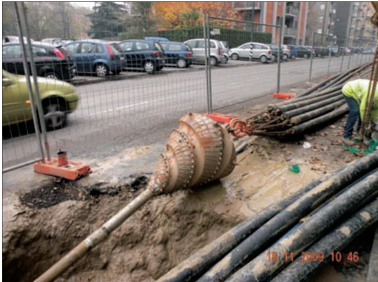
Fig. 9: Alesatore che trascina serie di tubi all'interno del foro partendo dal pozzo di arrivo (Fonte 1)
