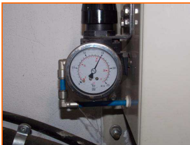
Figura 4: Dettaglio del manometro (indica 1,5 bar)
