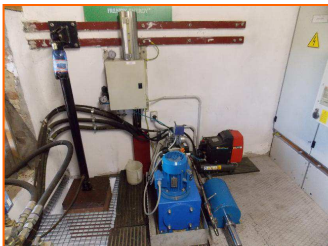
Figura 3: Sala controllo con sistema di pressurizzazione dell'impianto a turbina
