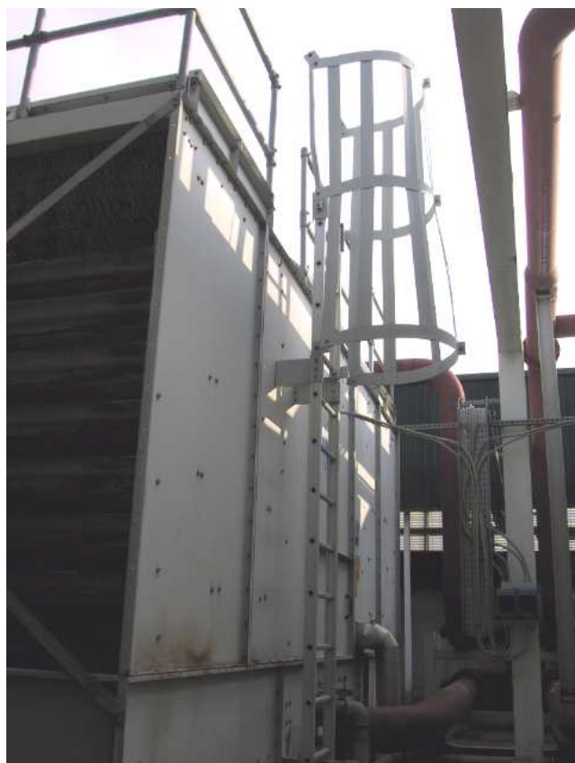
Scala fissa a pioli per l'accesso alla parte superiore delle torri evaporative.
