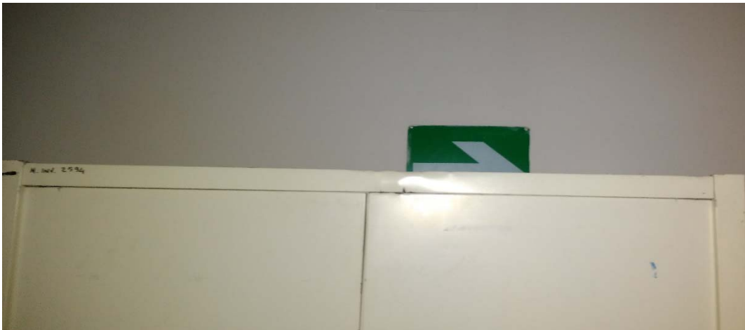
Foto 6 – Segnaletica via di esodo
