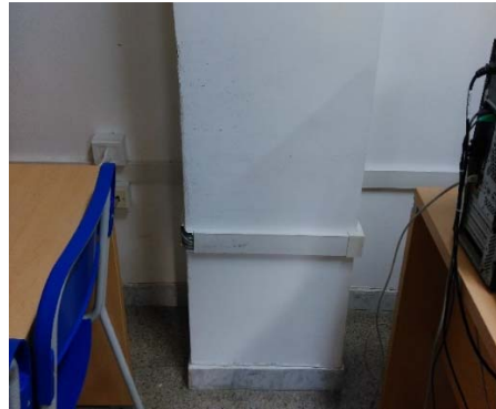
Foto 15 – Canalina per fili
