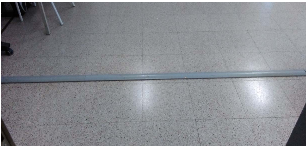
Foto 20 – Canalina per fili
