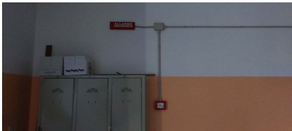
Foto 21 – Sistema allarme antincendio
