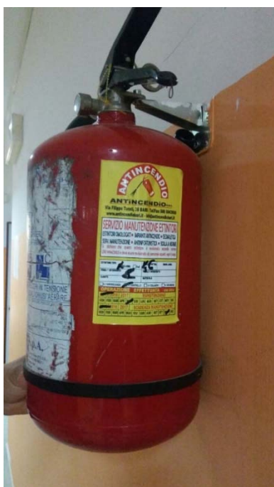
Foto 18 – Estintore con revisione scaduta
