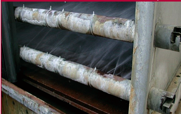
Figura 2 Aerosol prodotto all'interno di una torre evaporativa
