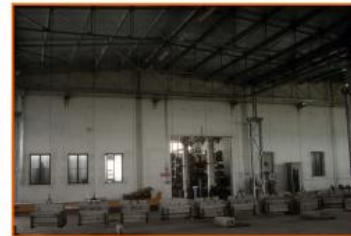
Prova di deformazione statica del tetto in acciaio di un capannone industriale. Pegognaga 1994
