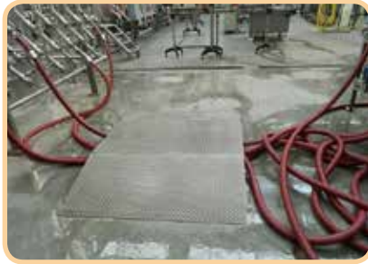
Copertura delle tubazioni enologiche con protezione calpestabile
