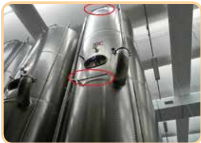
Silos in cantina: dispositivo di aggancio in quota per scala a pioli
