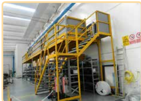
Soppalco con parapetto
