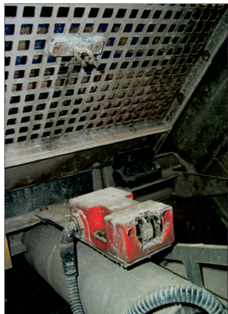
Abbildung 7: Verriegelungseinrichtung, die ungünstigen Umwelteinflüssen ausgesetzt ist
