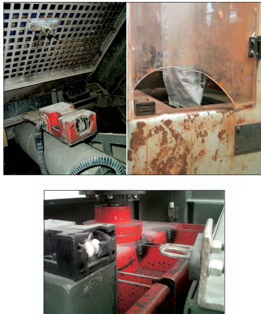
Abbildung 10: Versehentlicher Bruch: Verriegelung mit getrenntem Betätiger, die durch wiederholte Stöße aufgrund einer Fehlausrichtung zwischen Betätiger und Betätigungssystem beschädigt wurde
