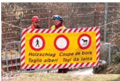
1 Sbarramento di un sentiero con un telone
