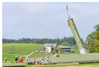
3 Non sostare sotto i carichi sospesi.
