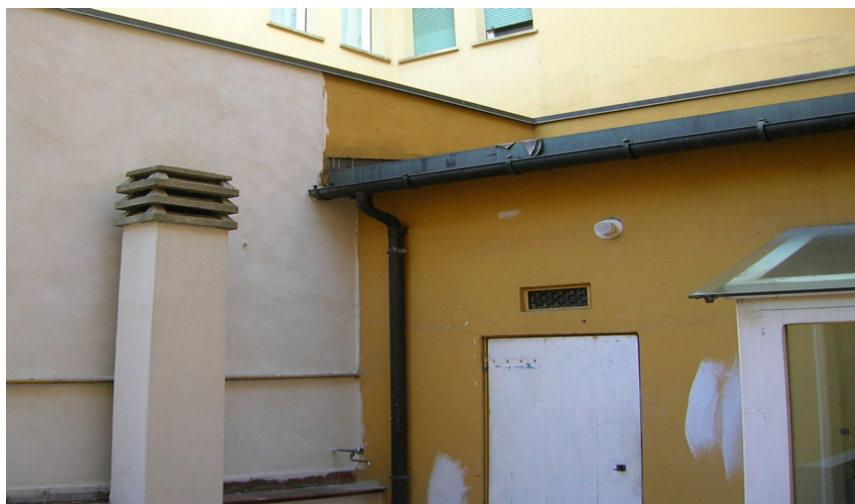
Fig. 4 - Scarico del generatore sul terrazzo di un'unità abitativa
