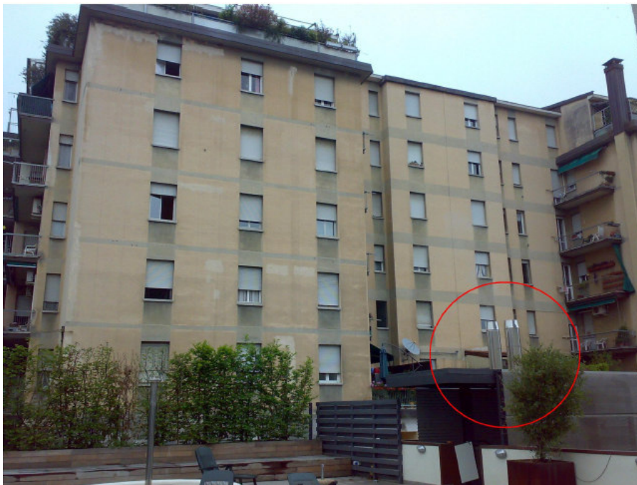
Fig. 6 - Camini di un impianto termico centralizzato
