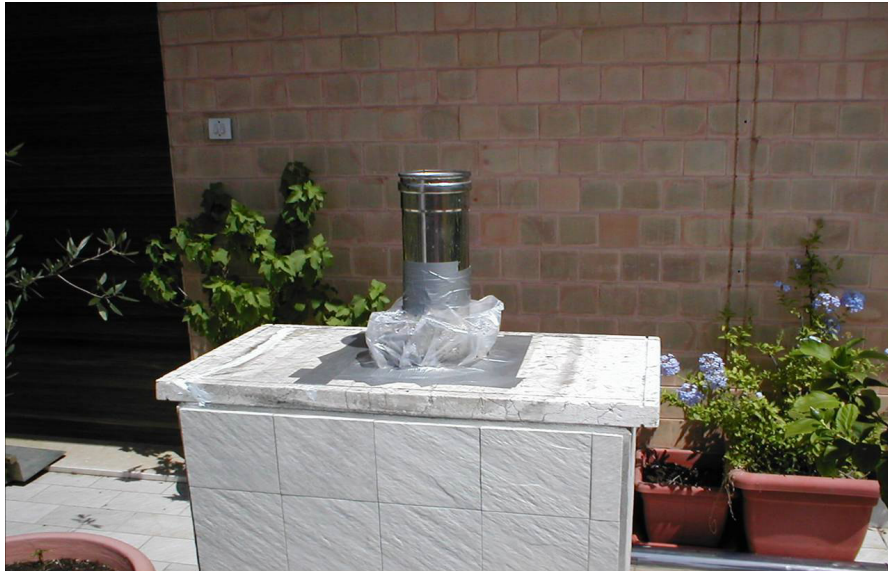
Fig. 5 - Scarico di un boiler sul terrazzo di un'unità abitativa
