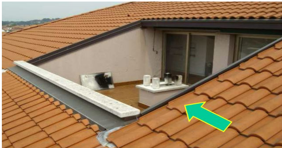
Fig. 7 – scarico su terrazzo interno con ristagno dei fumi
