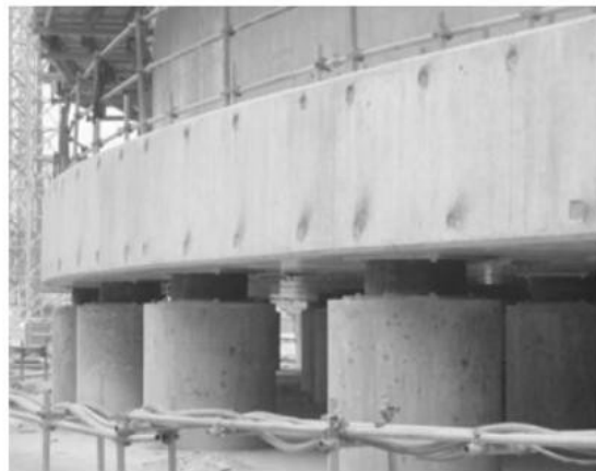
Alcuni dei 360 isolatori HDRB, di 700 mm di diametro, installati in uno dei 3 serbatoi LNG costruiti nella Provincia di Guangdong, nella Cina Meridionale (tali serbatoi hanno 84 m di diametro, 39 m d'altezza e pesano, quando pieni, 140.000 t)
