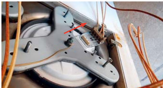
Pannelli leggeri contenenti amianto situati sotto il fornello (protezione anticendio)
