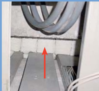
Barriera antifiamma con cuscini di amianto
