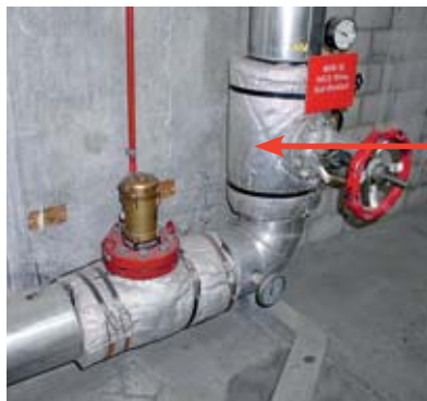
Rivestimenti di amianto termoisolanti
