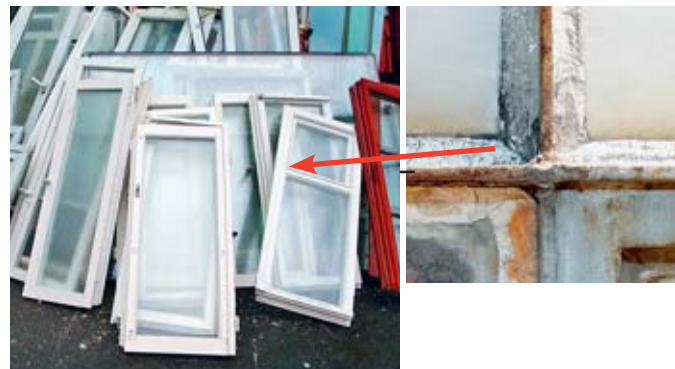
Lo stucco per finestre contiene amianto in matrice compatta
