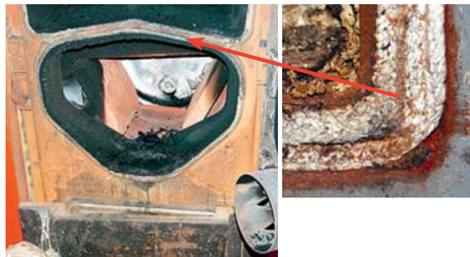
Cordone di amianto su una caldaia
