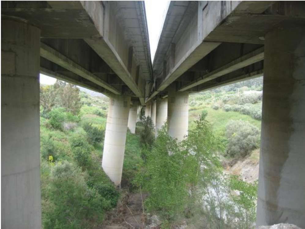
Figura 2.9: Comune di Caltavuturo (PA). Inclinazione dei piloni dell'autostrada A-19 CT-PA, investiti da un movimento franoso in data 10 aprile 2015. Fonte: Dipartimento di Protezione Civile Nazionale.
