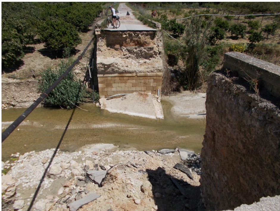
Figura 2.7: Crollo del ponte della SP 37 sul Fiume Sosio-Verdura, presso il comune di Caltabellotta (AG), a seguito delle piogge intense del 17 e 22 febbraio 2015. Fonte: Dipartimento di Protezione Civile Nazionale.
