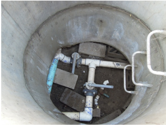
pozzetto valvole di isolamento
