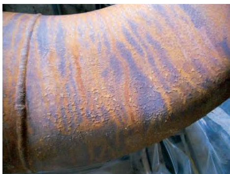
porzione di tubo affetta da vaiolatura
