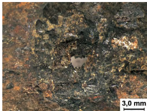
superficie esterna, lato danneggiato
