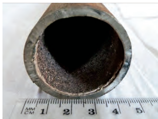
deposito sulla superficie interna
