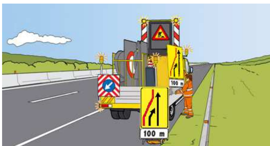
Figura 30 – Chiusura della corsia di sorpasso: scarico ed installazione del segnale di esclusione della corsia sul margine destro
