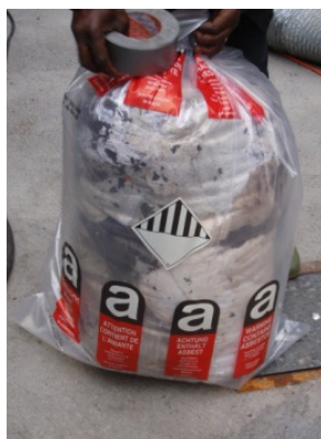
6 Sacco di plastica con l'etichetta «Amianto»
