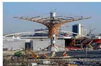
FENOMENO INFORTUNISTICO NEL CANTIERE EXPO 2015
