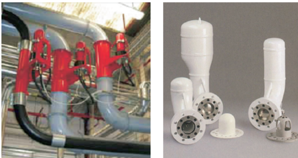
Figura 6: Sistemi di soppressione installati lungo le tubazioni del sistema
