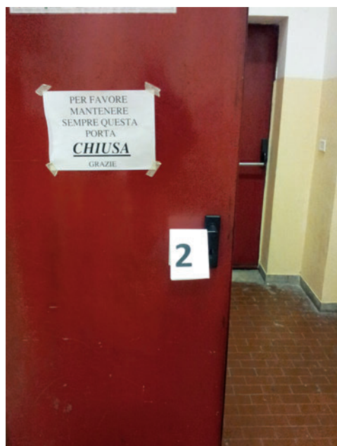
Porta tagliafuoco con protezione interna in amianto. In questo caso il campione è stato acquisito grazie a un guasto della serratura che esponeva il materiale a vista
