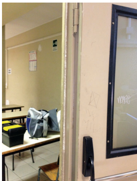
Porta di un'aula scolastica con corda in amianto a vista
