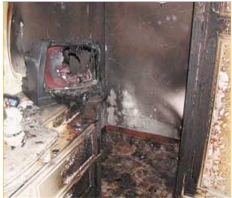
Surriscaldamento della presa multipla di alimentazione del televisore
