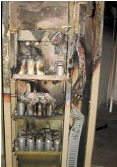
Scoppio di condensatori del sistema di rifasamento
