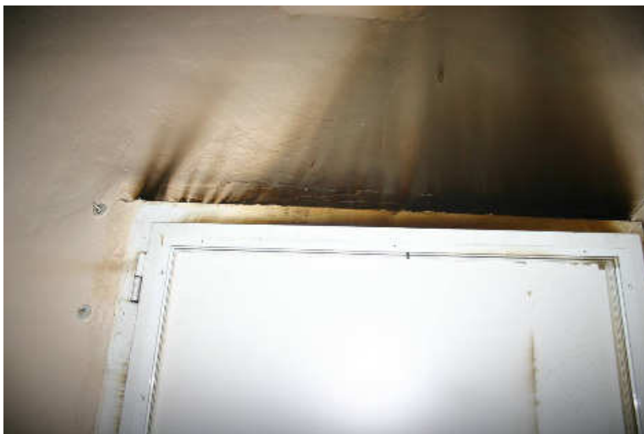
Foto NIA – Segni di nero fumo sulla parete al di sopra di una porta
