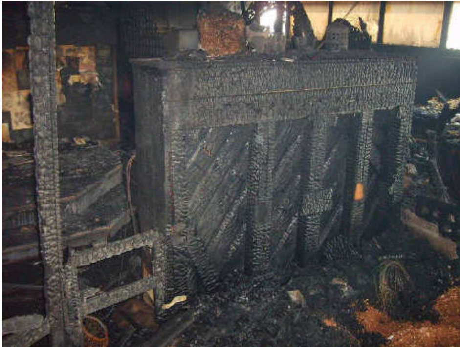
Foto NIA – Materiali lignei con screpolature tipiche provocate dall'incendio
