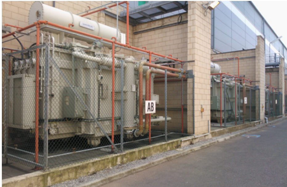
Figura 3.4 — Le zone dei trasformatori
