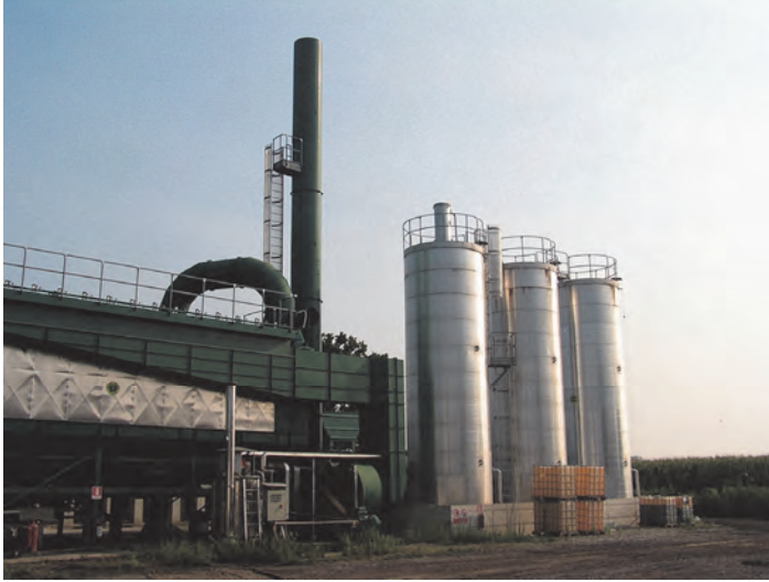
Figura 15 - Stoccaggio filler nello stabilimento di produzione
