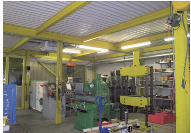
79 Tipico locale di fabbricazione: costruzione in acciaio con lamiera profilata, senza un efficace soffitto fonoassorbente. Questo locale è molto riverberante e il rumore emesso dal macchinario è molto fastidioso in tutto il locale.
