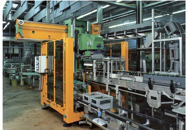
81 Soffitto fonoassorbente in una fabbrica di imbottigliamento. Qui si impiegano dei pannelli in lana minerale (cosiddetti «baffles»).
