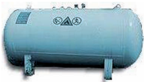
8.11 - Deposito di GPL costituito da serbatoio fuori terra
