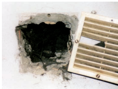
8.25 - Apertura di ventilazione in condizioni critiche sia per la realizzazione, sia per le condizioni di mantenimento
