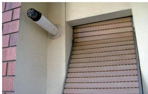
8.26 - Posizionamento scorretto di un terminale di scarico a parete posto a distanza non corretta rispetto la finestra adiacente
