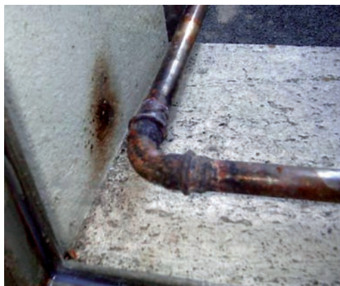
8.23 - Giunzione inidonea perché in esecuzione brasata anziché a pressare come necessario in relazione al tipo di raccordo presente
