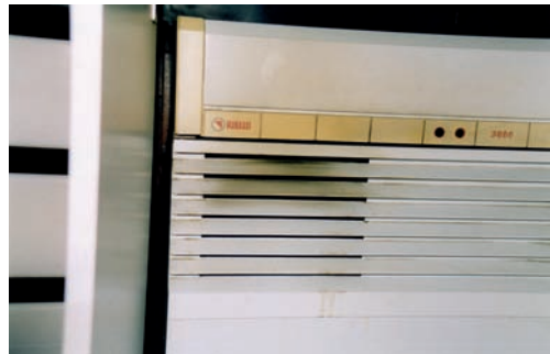
8.24 - La presenza di nerofumo sull'apparecchio denota un riflusso dei prodotti della combustione in ambiente e quindi che durante l'esercizio si sono verificate condizioni di pericolo
