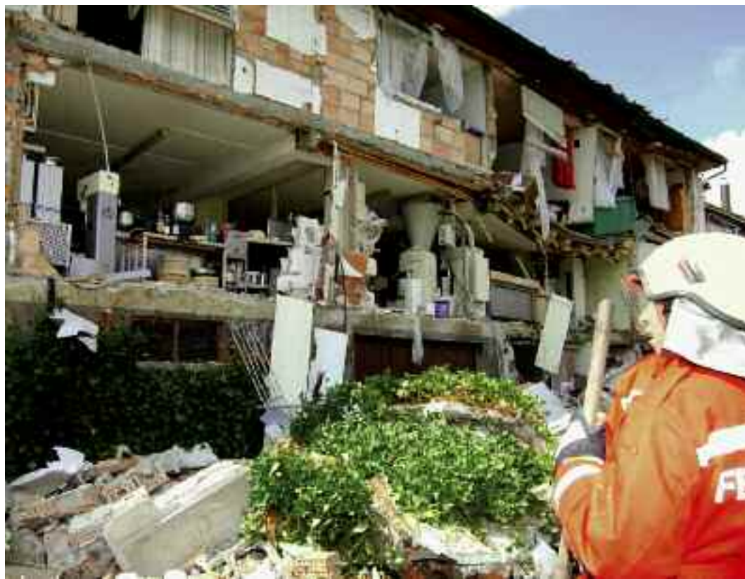
Effetti di un'esplosione di gas.
