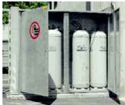
Gas liquefatto stoccato all'aperto – non accessibile alle persone non autorizzate (a prova di vandali!).
