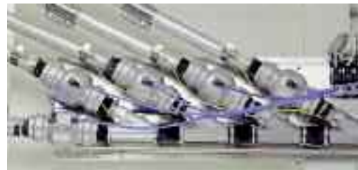
Tubo di alimentazione della farina, i componenti intermedi sono conduttori di elettricità e dotati di messa a terra (ATEX).
