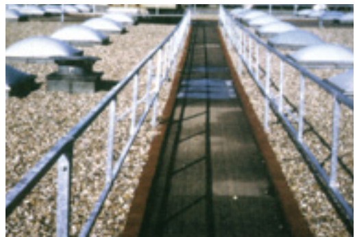
Photo 7.3. Passerelle permanente d'accès pour l'entretien d'installations sur toiture.
