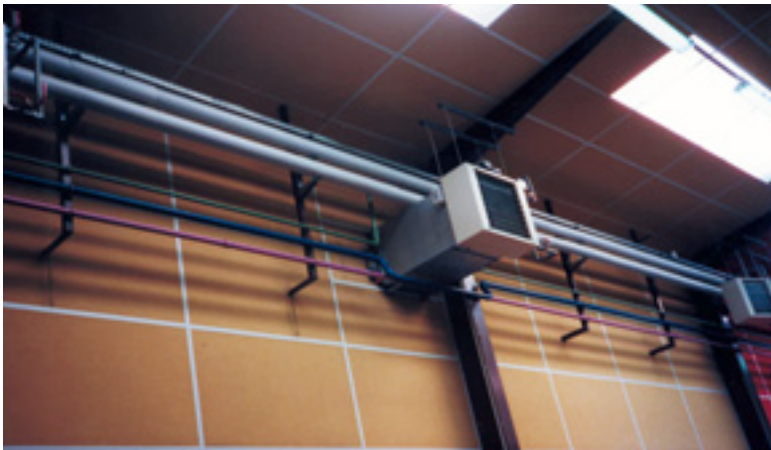
Photo 5.5. Système de chauffage d'un atelier.
