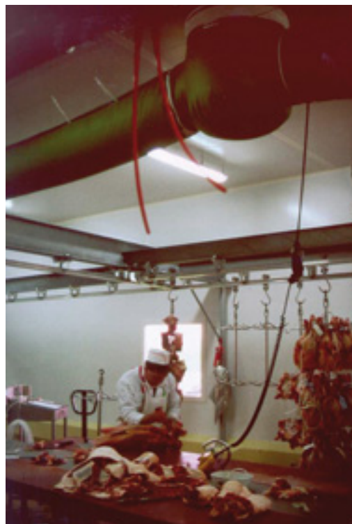
Photo 5.4. Gaines textiles dites « chaussettes » pour diffusion d'air à basse vitesse.
