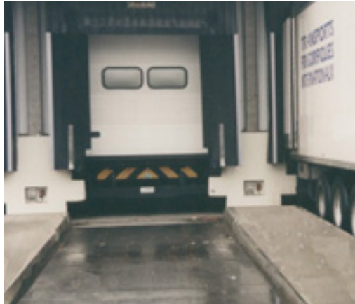
Photo 7.7. Quai aménagé avec guide-roues, rampe ajustable sur quai, butoirs assurant un espace de 500 mm, niche à hayon, prises électriques pour groupe frigorifique avec passage pour le hayon en partie inférieure.
