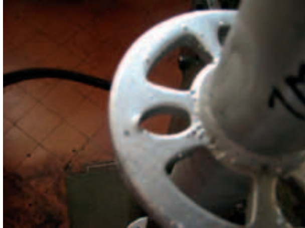
Figura 4.2.2.4-9: Fine prova - Deformazione permanente (ovalizzazione) del foro della rosetta
