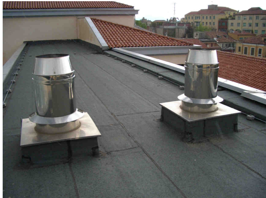
Scarichi della Centrale Termica di un Edificio per il Terziario
