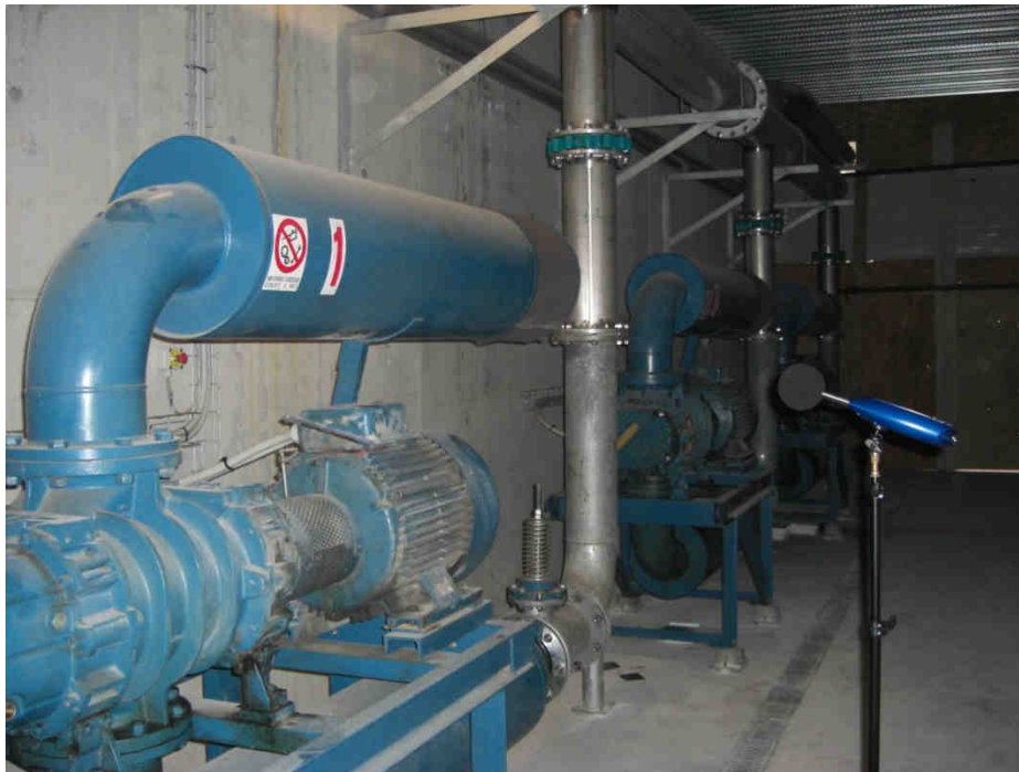
Sala Soffianti su Depuratore di un Macello Avicolo
