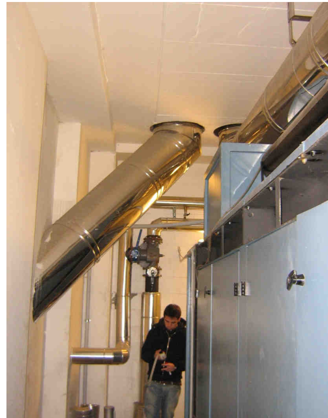
Impianto di Cogenerazione Sotterraneo in Condominio
