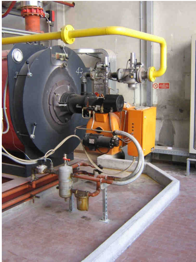
Centrale Termica di un Ospedale
