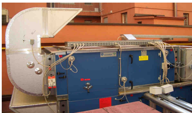
Unità Trattamento Aria (U.T.A.)
