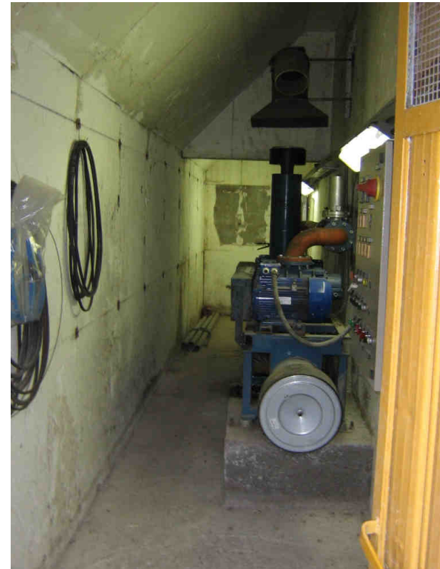
Sala Soffianti su Depuratore Civile
