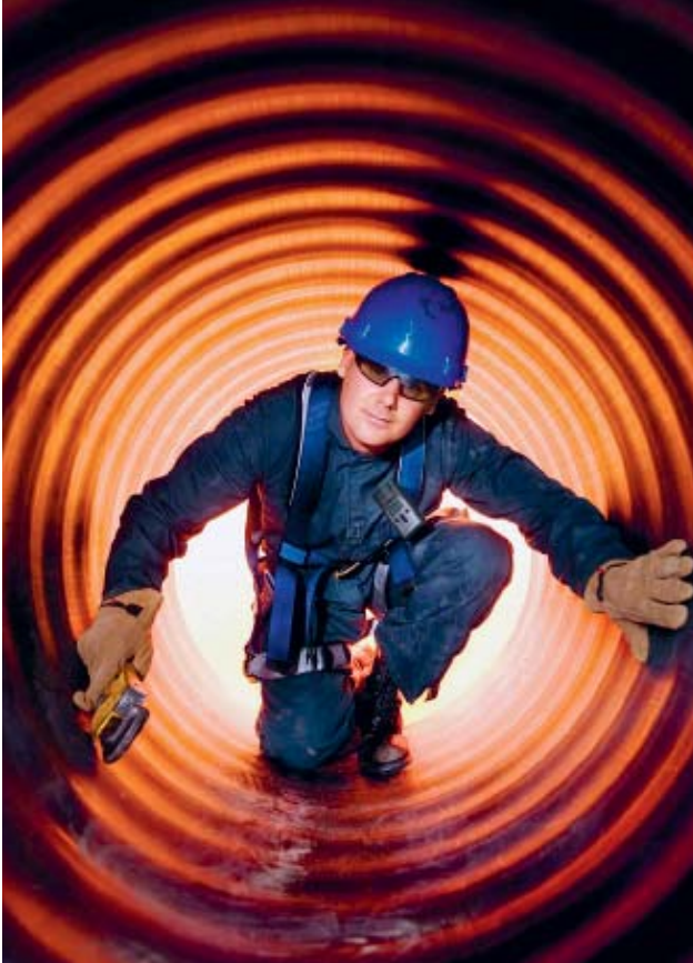
Fig. 4 In caso di lavori in locali stretti la persona deve essere sorvegliata costantemente.
