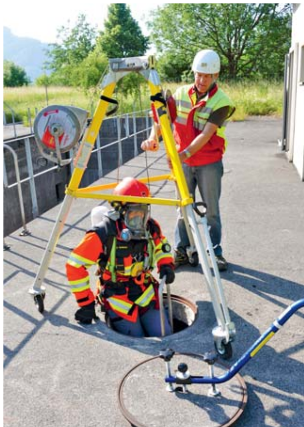
Fig. 3 L'operaio che entra in un pozzo viene sorvegliato direttamente da un'altra persona.
