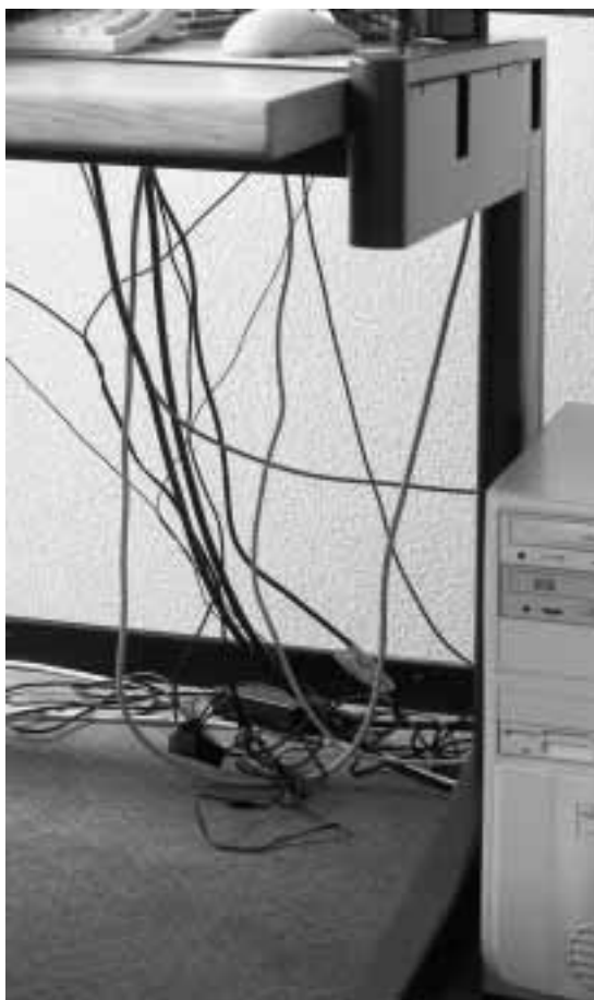
Figura 66 Groviglio di cavi
