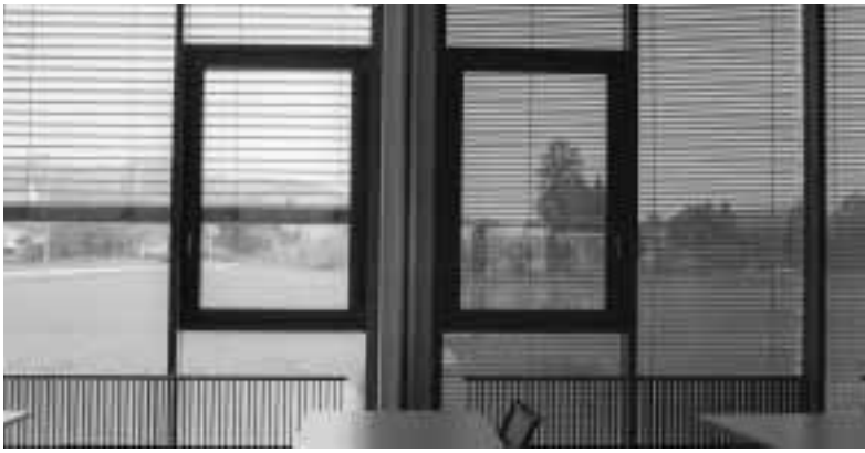
Figura 104 Veneziane a lamelle perforate (nell'immagine a sinistra in parte aperte, a destra chiuse)
