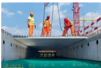
1 Predisporre per prima cosa i dispositivi di protezione collettiva (ad esempio montare le reti di sicurezza).
