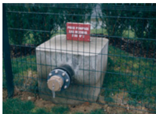
Photo 6.1.b. Prise d'eau à l'extérieur de l'enceinte grillagée.
