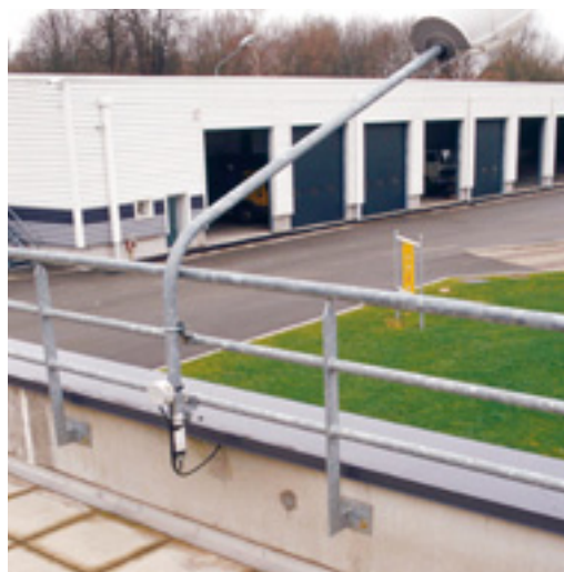
Photo 5.2. Luminaire pivotant pour le remplacement d'ampoule.
