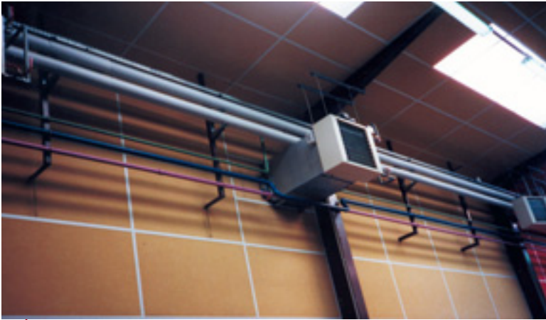
Photo 5.5. Système de chauffage d'un atelier.
