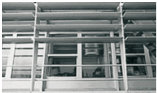
Photo 5.1. Dispositif de lames brise-soleil.
