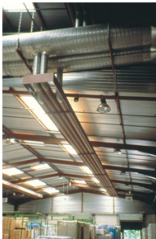
Photo 5.3. Chauffage des locaux réalisé à partir de canalisations d'air chaud agissant par rayonnement.
