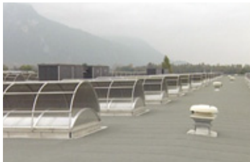
Photo 5.6. Exemple de protections solaires par l'extérieur sur lanterneaux en toiture, groupes de rafraîchissement d'air (caissons noirs au fond), extracteurs d'air (à droite).
