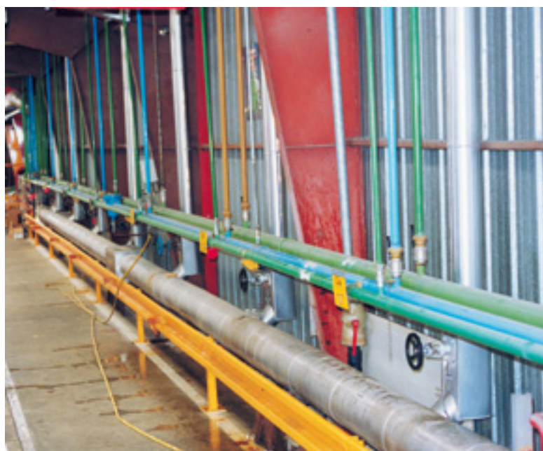
Photo 8.6. Fluides. Système de couleur pour le repérage des circuits des différents fluides.
