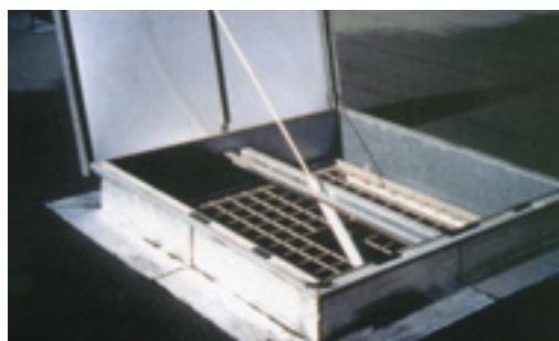
Photo 7.2. Lanterneau ouvrant équipé de grilles de protection en sous-face.
