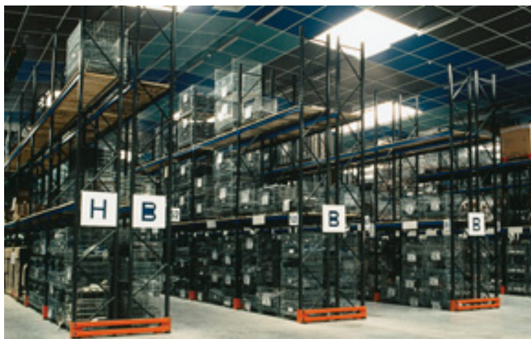
Photo 8.3. Exemple de racks aménagés sur le plan de la sécurité : plancher de positionnement et butées de pied d'échelle.
