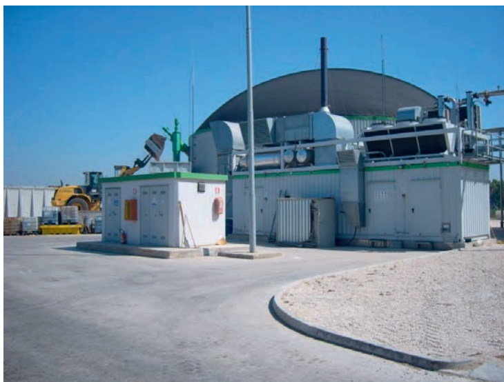
Figura 7 - Gruppo di cogenerazione
