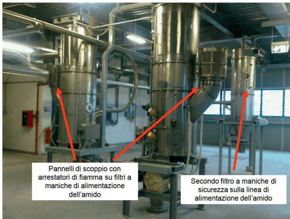
Figura 4 - Filtri a maniche e secondo filtro di sicurezza
