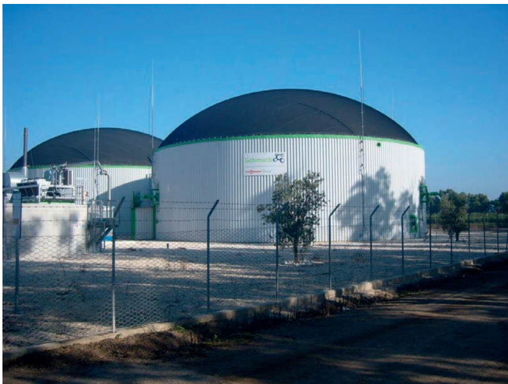
Figura 16 - Parafulmini a protezione del reattore anaerobico
