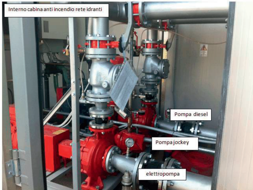
Figura 20 - Pompe della stazione di pompaggio
