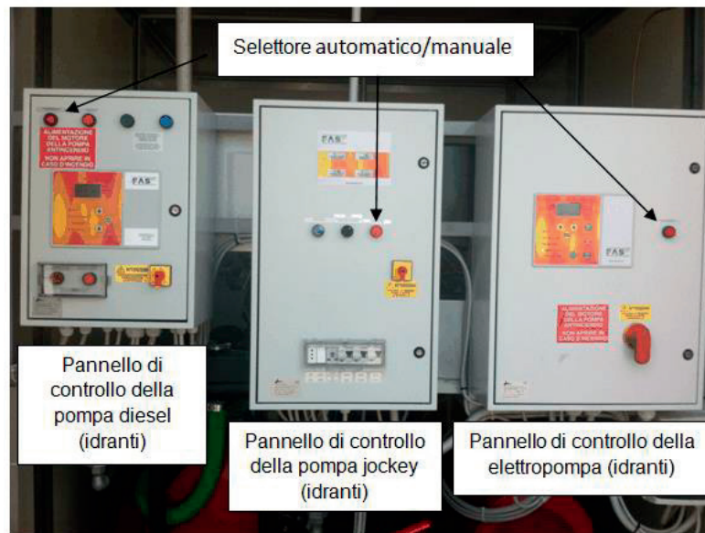
Figura 23 - Pannelli di controllo delle pompe
