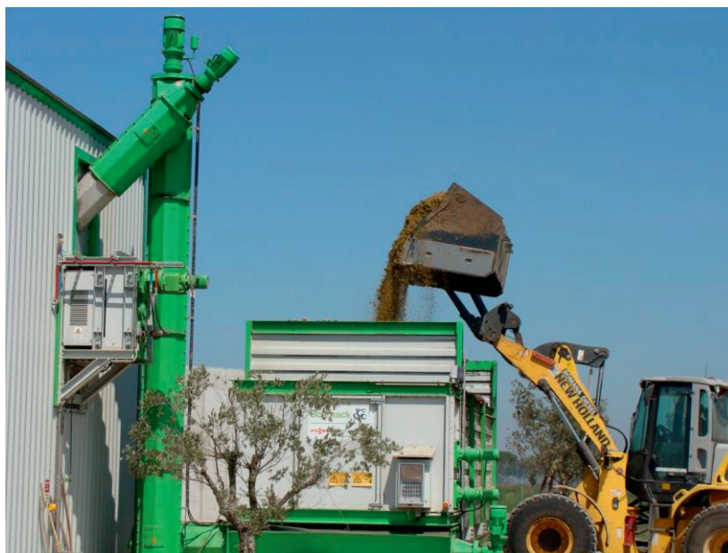
Figura 4 - Coclea di alimentazione del digestore
