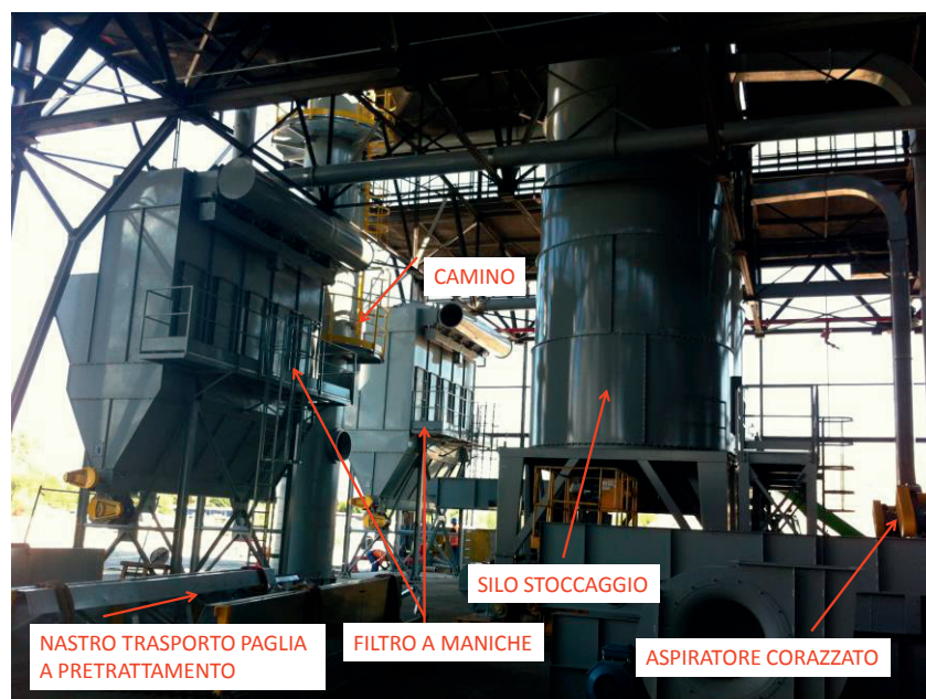
Figura 6 - Sezione dell'impianto di alimentazione della paglia dove sono visibili i filtri a maniche, l'aspiratore corazzato ed il camino
