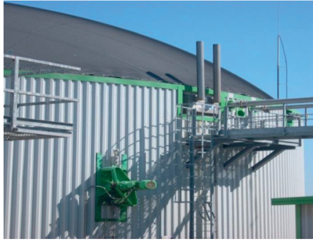
Figura 12 - Valvola di sicurezza a guardia idraulica
