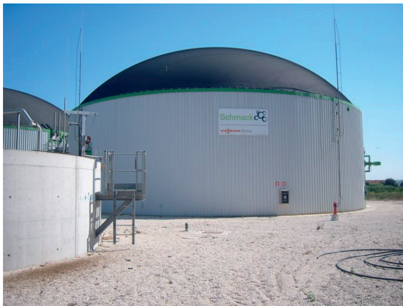
Figura 10 - Unità di stoccaggio del biogas
