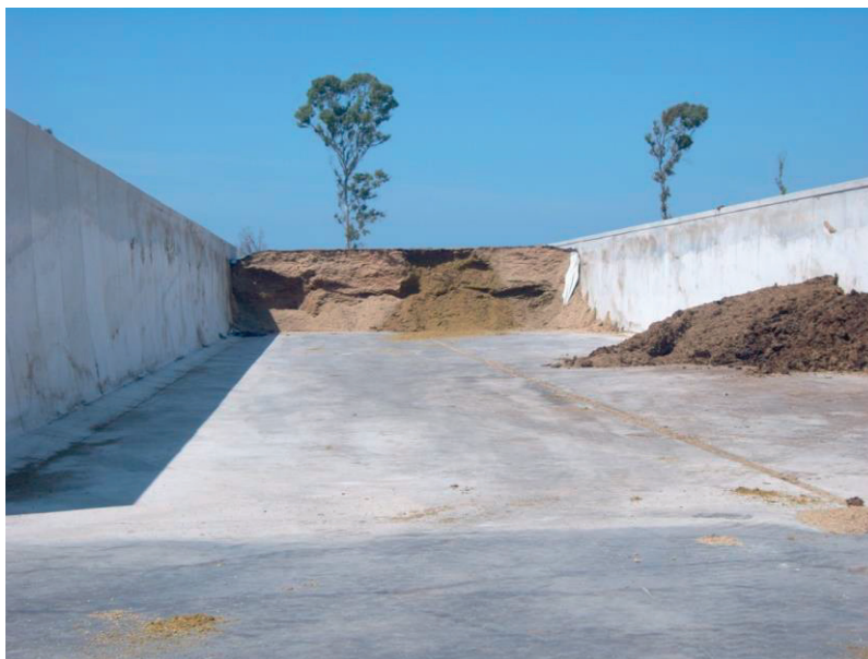
Figura 2 - Trincea di stoccaggio delle biomasse solide
