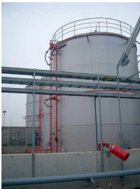
Figura 17 - Impianti fissi a diluvio installati sui serbatoi di stoccaggio del bioetanolo
