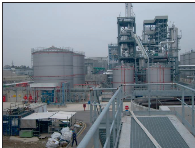
Figura 15 - Serbatoi di stoccaggio del bioetanolo
