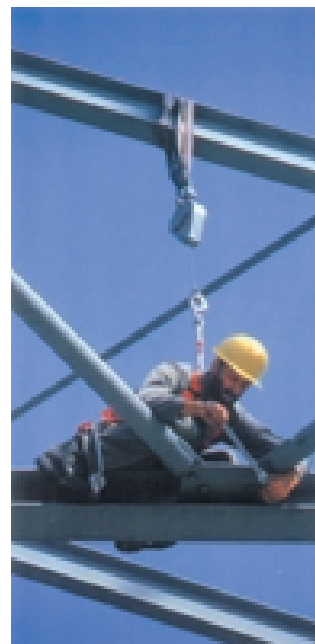
Esempio di sistema anticaduta con uso di imbracatura - fune di sospensione avvolgitore - ancoraggio
