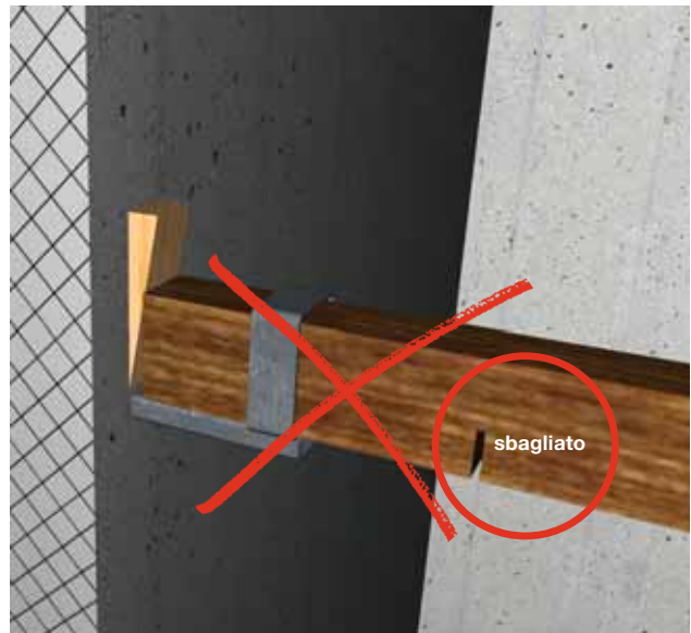
2 Travetto che presenta un danno meccanico. I travetti che presentano simili danni non devono essere assolutamente usati. Anche per i travetti corti occorre usare solo legno di qualità controllata.
