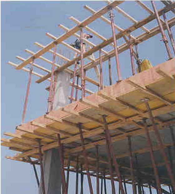
Fig. 4 Assenza di protezioni contro la caduta
