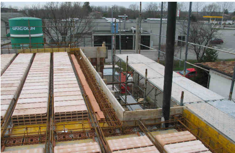
Figura 6- rientranza edificio priva di ponteggio
