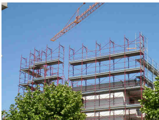
Figura 13– Ponteggio privo di ancoraggio
