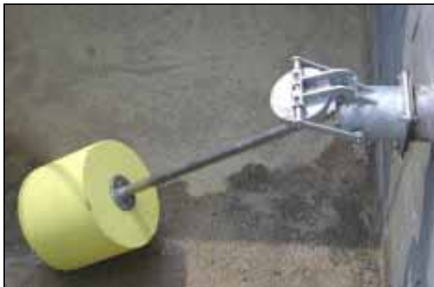
Figura 74 – Valvola galleggiante: sistema di riempimento del pozzettone di prelievo liquami
