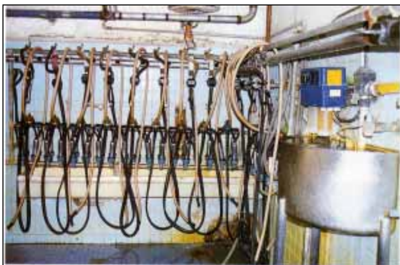
Figura 11 - Rastrelliera per il lavaggio dei gruppi di mungitura di un impianto a lattodotto.
