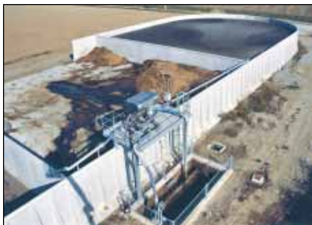
Figura 75 – Platea di stoccaggio dei reflui solidi realizzata vicino alla vasca di stoccaggio dei reflui liquidi.
