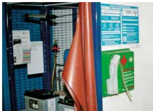
6 Stazione caricabatterie: pericolo di corrosione ed esplosione.
