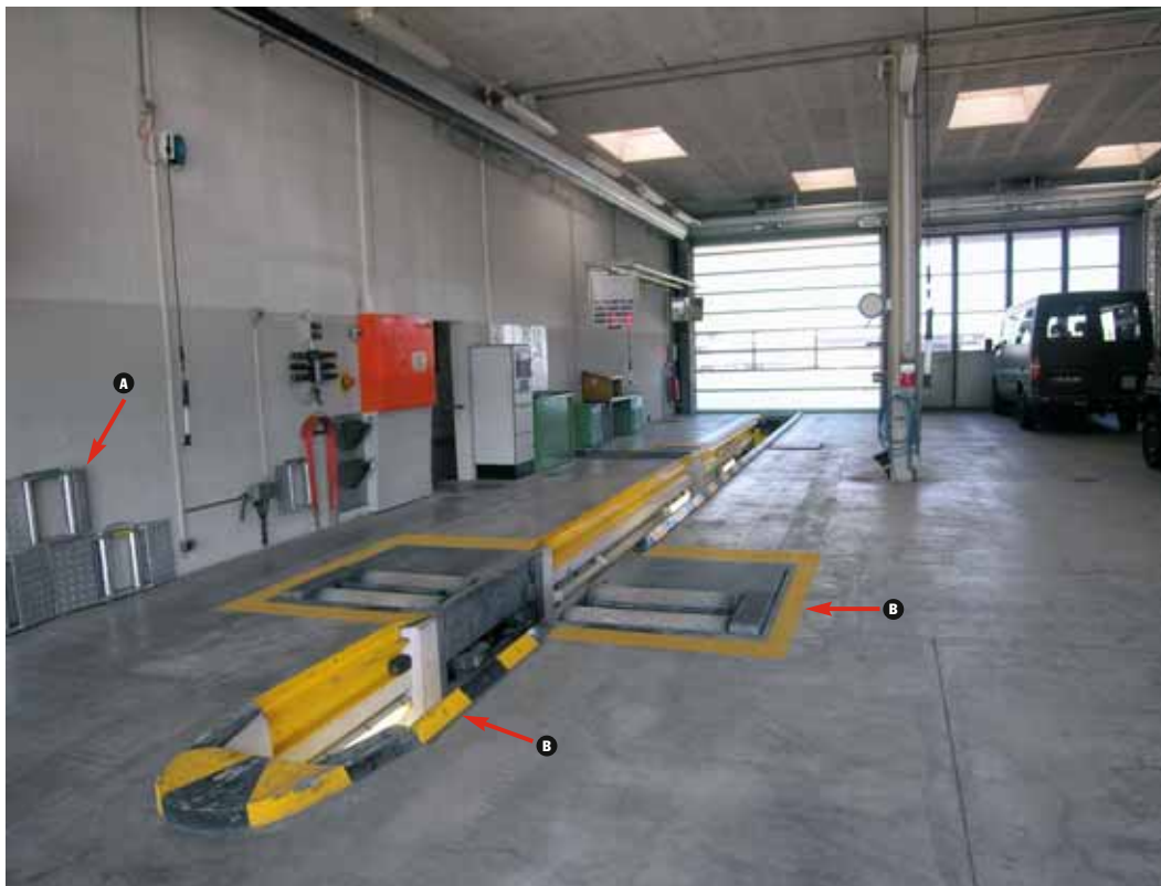
A Oggetti fissati e messi in sicurezza. B Segnalare i punti pericolosi.
