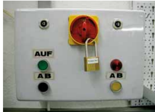
Evitare che le attrezzature possano essere riavviate.
