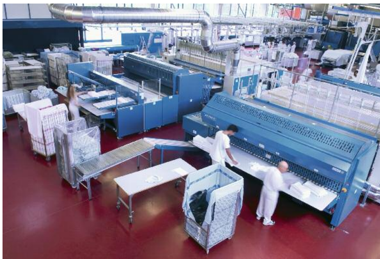
Le installazioni e le apparecchiature tecniche devono essere conformi alle norme di sicurezza.
