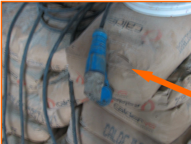
Impianto elettrico volante
