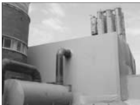
Figura 16: Condotto di collegamento al sistema di abbattimento
