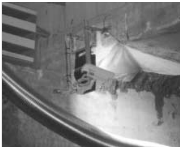
Figura 21: Telecamere installate all'interno delle vasche
