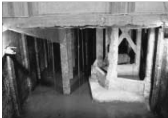
Figura 33: Vasca allagata dalle acque piovane
