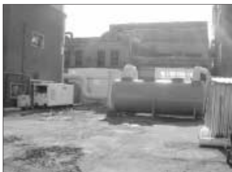
Figura 15: Cisterne contenenti carboni attivi
