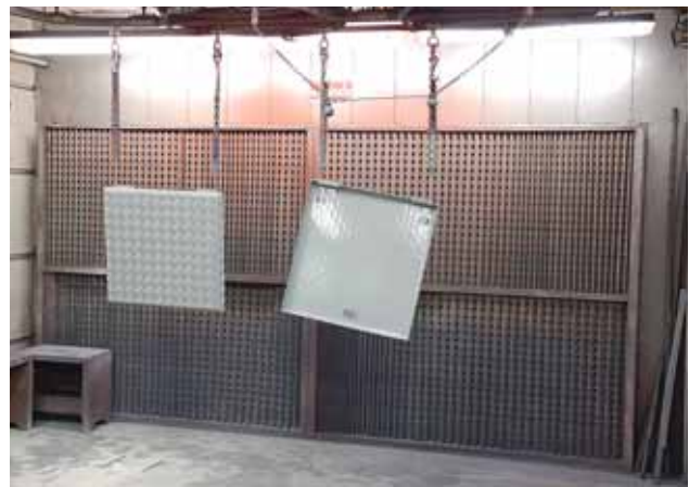
Fig. 5: posto di verniciatura con parete di aspirazione. L'aria fresca viene immessa dal lato opposto del locale. La sospensione è dotata di un dispositivo di rotazione in modo che i pezzi vengano verniciati sempre da davanti.
